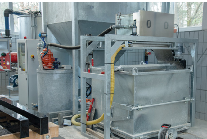
Der Betrieb kann dank PV- und Wasseraufbereitungsanlage im Sommer nahezu autark produzieren.
